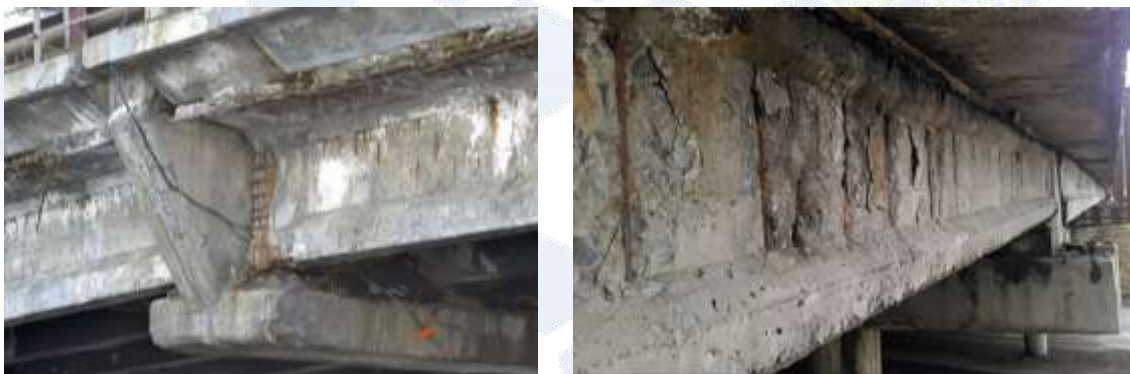
1-rasm. Temirbeton ko'prik konstruktiv elementlarining yemirilishi
