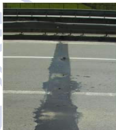
Рис.4. Поврежденный деформационный шов типа битумно-эластичного наполнителя
