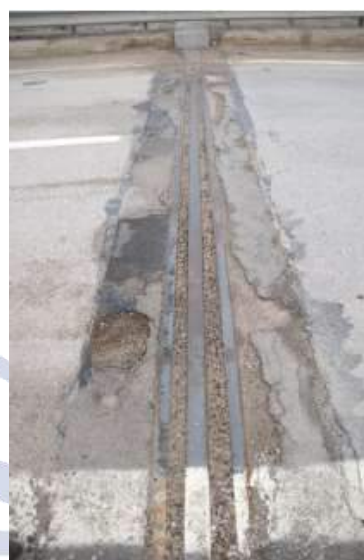
Рис.8. Износ шва на подходном бетоне, слой которого поврежден
