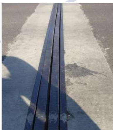
Рис.3. Компенсатор, которое нигде не равно расстоянию между профилями, а в некоторых местах даже перекрывается
