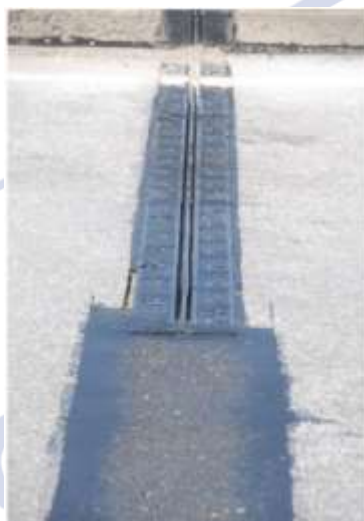
Рис.5. Временный ремонт отломанных участков армированного эластомерного шва
