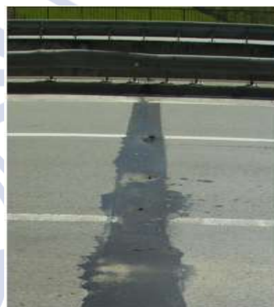
Рис.4. Поврежденный деформационный шов типа битумно-эластичного наполнителя
